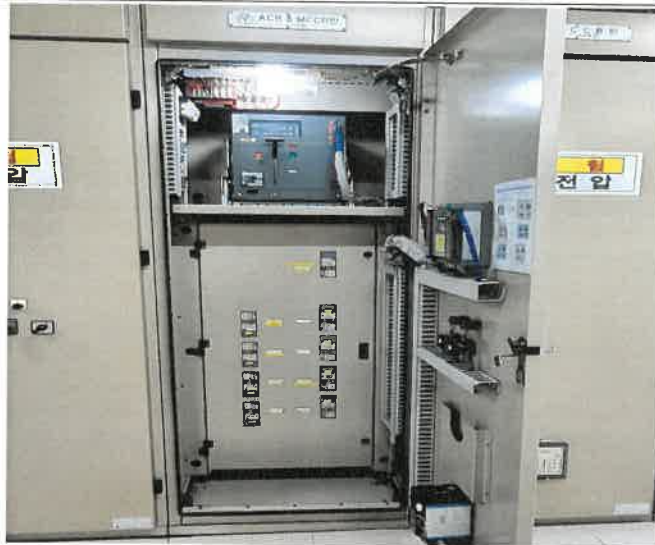
지하5층 전기실 교체 배전 차단기
