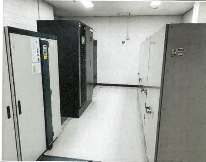
지하5층 전기실 내 UPS
