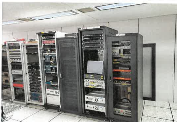
5층 전산실 신규 분전함 설치 구역
